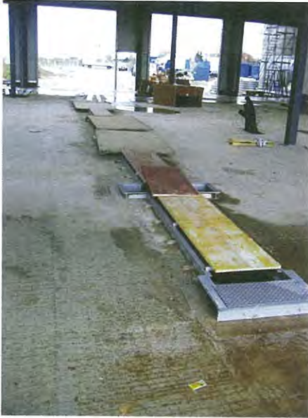
■ Abb. 8.4 Verkehrswege vor Arbeitsbeginn kontrollieren
