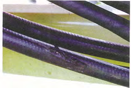
■ Abb. 9.1 Defekte Schlauchleitung der Ölhydraulik
